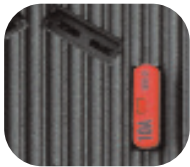
Notfunktion durch Umstecken des Sicherungsautomaten
